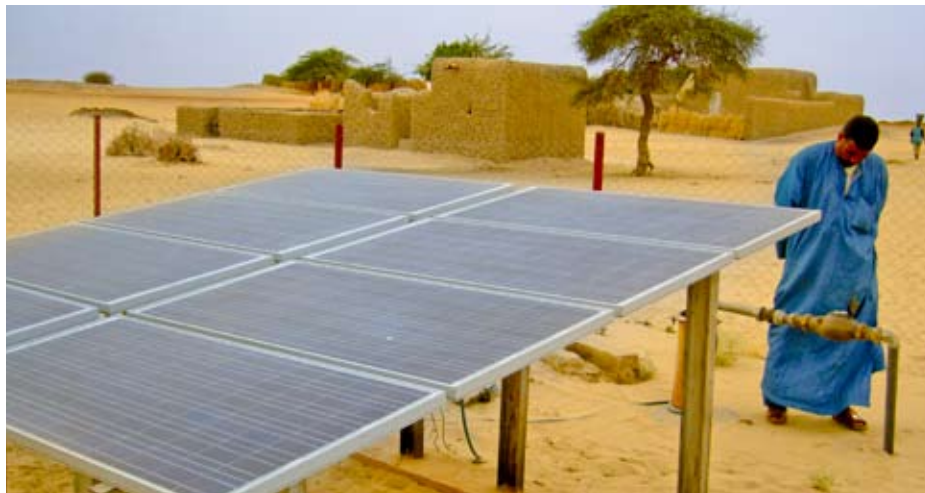
Solare Trinkwasseranlage Boukayatte bei Timbuktu
